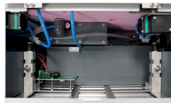
Illustration : Porte de service ouverte sans cartouche sèche ni capteur de contrôle
